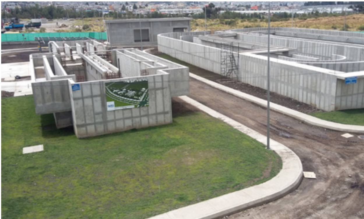
QUITO (ECUADOR) - IMPIANTI DI TRATTAMENTO DELLE ACQUE REFLUE DI QUITO (2012 - 2014)
